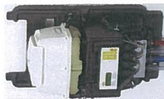
Geöffneter Innenschaltschrank mit Schlauchanschlüssen
