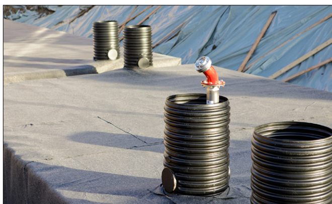
In einem Teleskopschacht der Löschwasserspeicher- und Regenwassernutzungsanlage ist ein Löschwasser-Sauganschluss mit Peilstützen und A-Festkupplung integriert. (Foto: GRAF)
