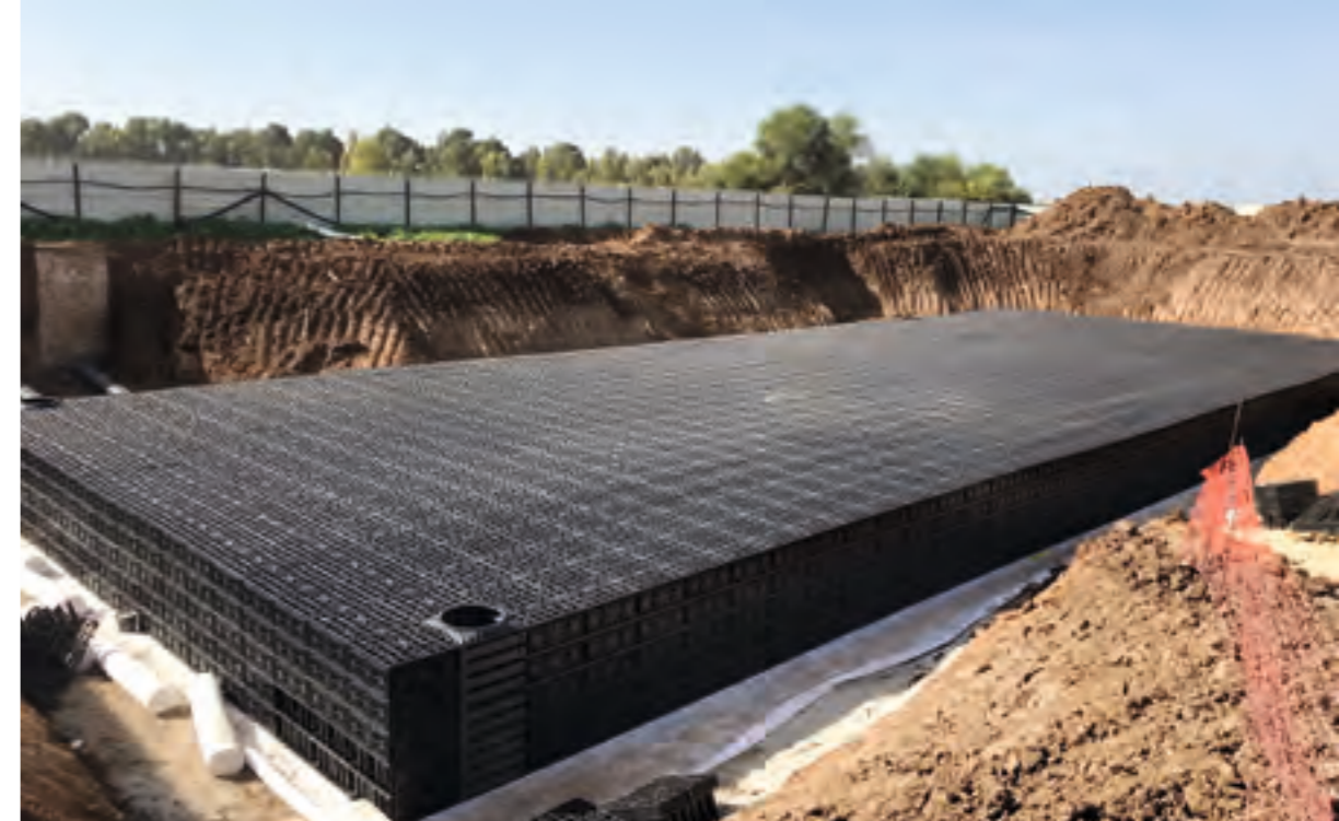
^ Versickerung von Niederschlägen Im erdgasbetriebenen Kraftwerk Plugot im südlichen Israel hat GRAF das System EcoBloc maxx mit einem Fassungsvermögen von 980 Kubikmetern unter dem Mitarbeiter-Parkplatz eingebaut. 800 Versickerungsmodulare aus 100 Prozent Recycling-Kunststoff dienen der Regenwasserversickerung
