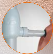
Conexión entre ánfora y filtro de bajante
