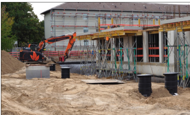
Über dem Rigolenkörper wurde mit dem Aushub der Grube eine Überdeckung von 100 cm mit SLW 60 hergestellt. (Foto: GRAF)
