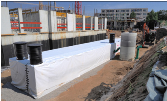
Die Module wurden vor Ort zu einem kompakten Verbund vormontiert und mit GRAF-Tex Geotextil umschlossen. (Foto: GRAF)
