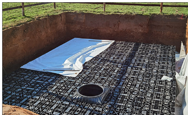
Die Dachentwässerung der drei Wohngebäude erfolgt in eine Versickerungsanlage aus GRAF EcoBloc Inspect 420 Modulen mit 19.880 l Fassungsvermögen. (Foto: Brucker)
