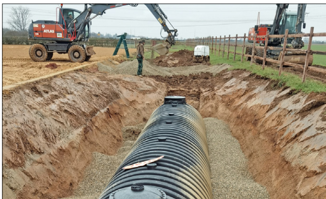
Das Regenwasser der Dachflächen der Reithalle, der Longierhalle, des Multifunktionsstrakts und der umgebenden gepflasterten Hofflächen wird in einem 56.000 l fassenden Erdtank GRAF XXL Carat gesammelt. (Foto: Brucker)
