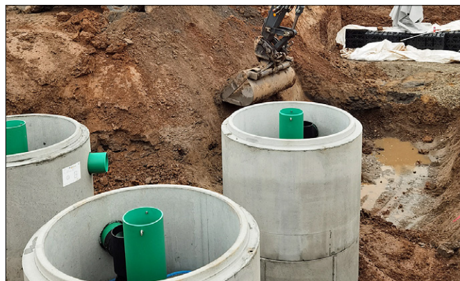
In der GRAF Substratfilteranlagen EcoClean 1500 wird das Wasser in einem Prozess von Sedimentation, Filterung und Adsorption gereinigt. (Foto: Brucker)
