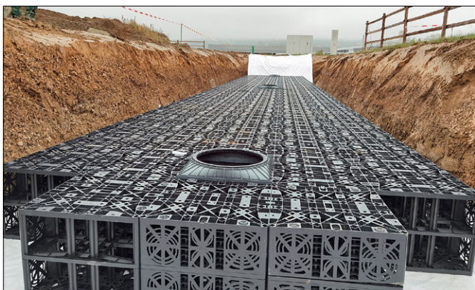
Die Versickerungsanlage für die Dachentwässerung des Stallgebäudes besteht aus GRAF EcoBloc Inspect 420 Modulen mit 63.260 l Fassungsvermögen. (Foto: Brucker)
