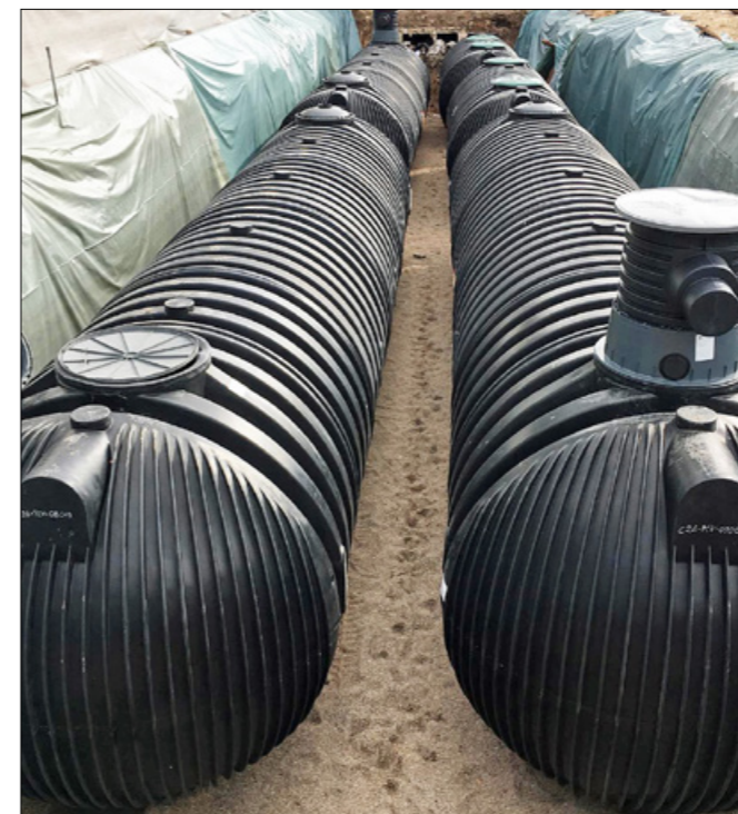
Der als Pufferspeicher fungierende Tank ist mit KG-Rohren (DN 200) mit den vier Speichertanks GRAF Carat XXL verbunden.
